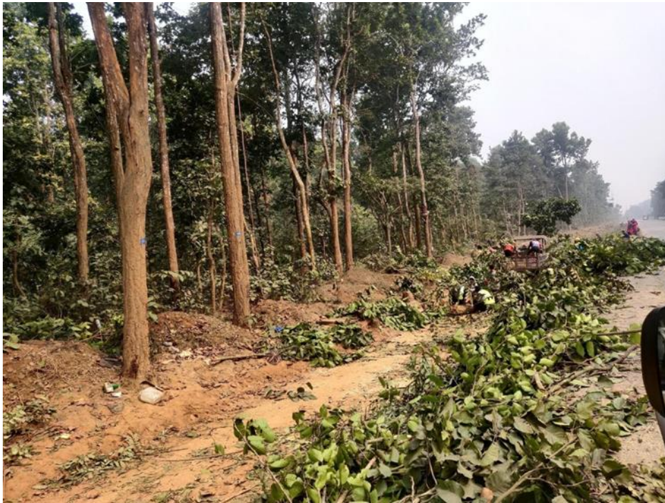
ภาพที่ 18 แสดงการก่อสร้างเริ่มขึ้นจากการกำจัดพืชพรรณบนทางขวาของทางบนถนน 2 เลนระหว่าง Narayanghat และ Butwal (NB) เครดิตแก่ Anthony P. Clevenger.
